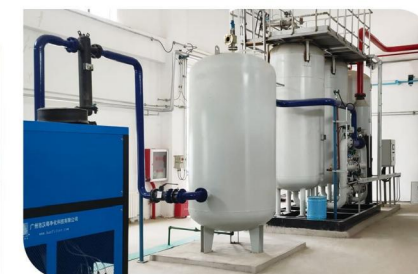
苏州科环运行现场
