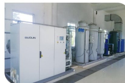
无锡自来水厂运行现场
