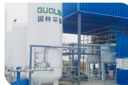
江苏联发环保新能源运行现场
